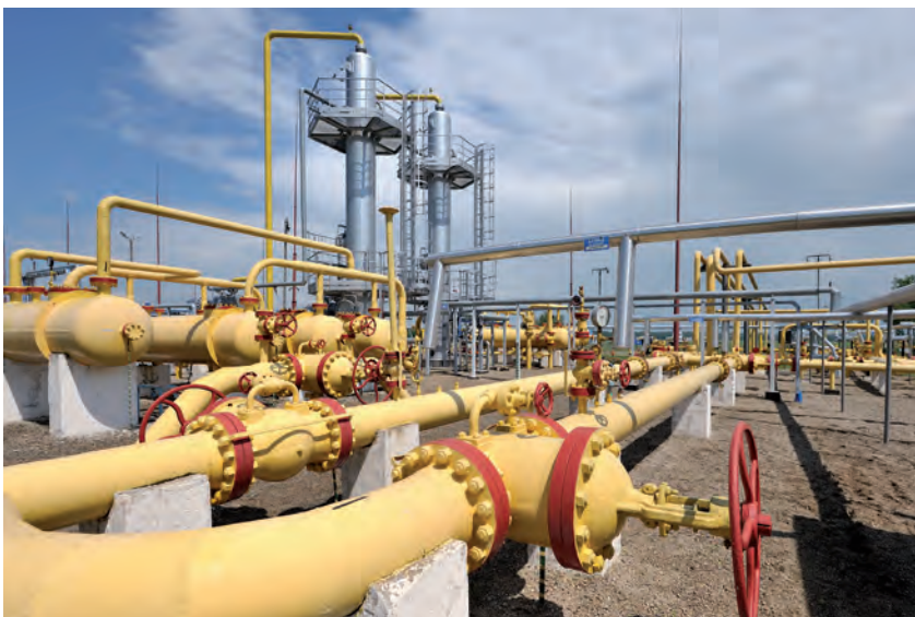
W 2003 r. na KGZ Załęcze wybudowano nową instalację kolumnową do osuszania gazu. Fot. Paweł Chara
