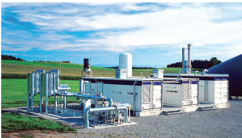
Rys. 3. Widok instalacji do uzdatniania biogazu w biogazowni Kisslegg Rahmhaus
