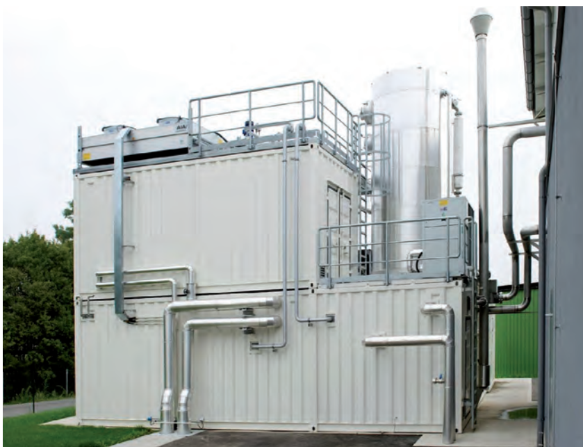
Rys 4. Widok instalacji do uzdatniania biogazu w biogazowni Engerwitzdorf
