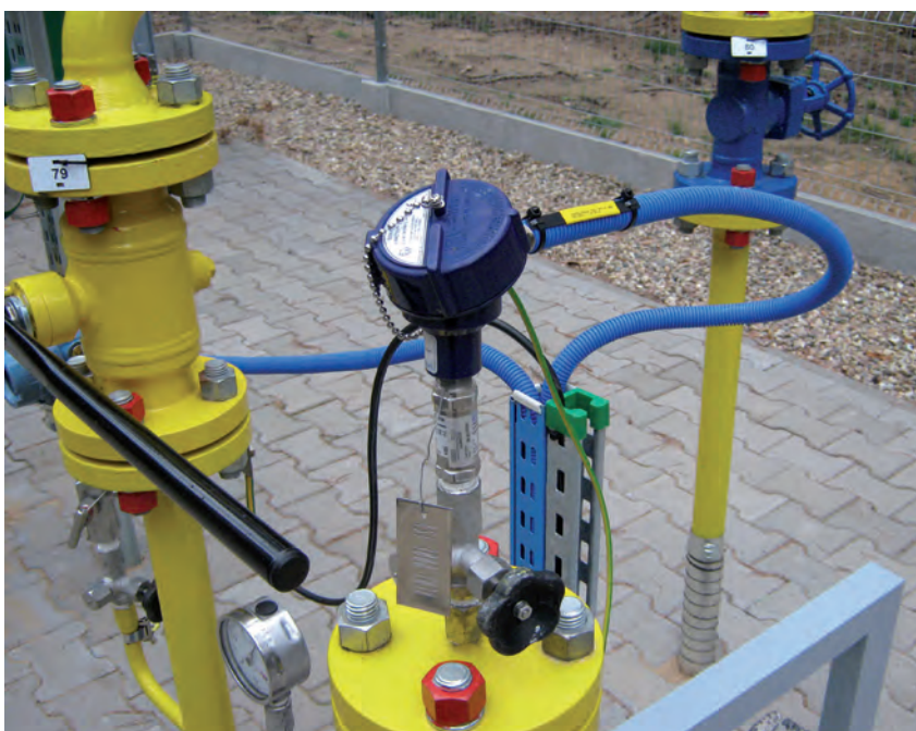
Przetwornik akustyczny zamontowany na gazociągu. Fot. Tomasz Klemenski
