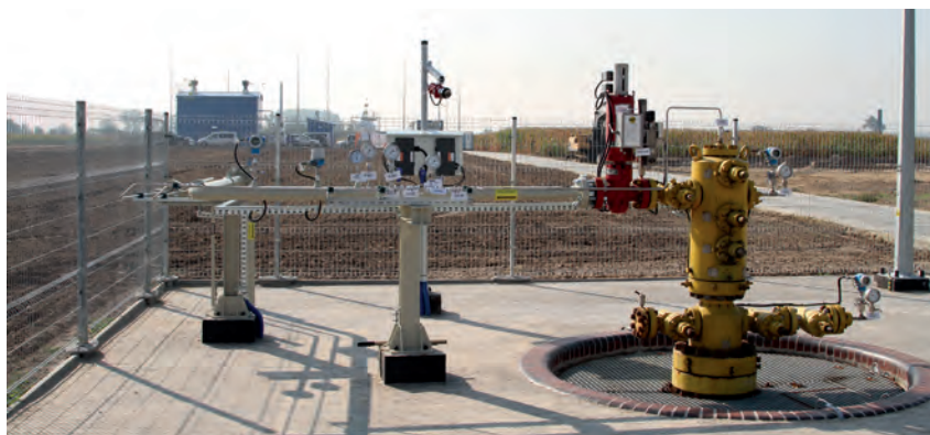
Gaz ziemny ze złoża Karmin-1 wydobywany jest z następującymi parametrami: 6 000 m 3 /h przy ciśnieniu 18,2 MPa. Fot. Marcin Kamycki
