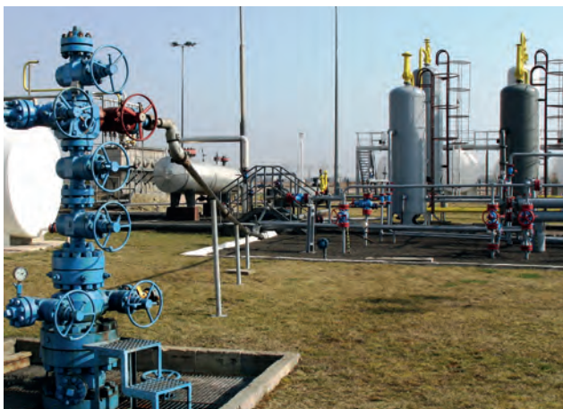
Głowica odwiertu Buk IG-1 z urządzeniami kopalnianymi. Fot. arch. PGNiG SA Oddział w Zielonej Górze
