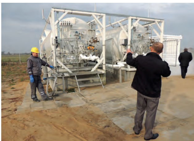
Stacja regazyfikacji LNG w Lasocicach (KZ 5). Fot. arch. SITPNIg Oddział w Poznaniu
